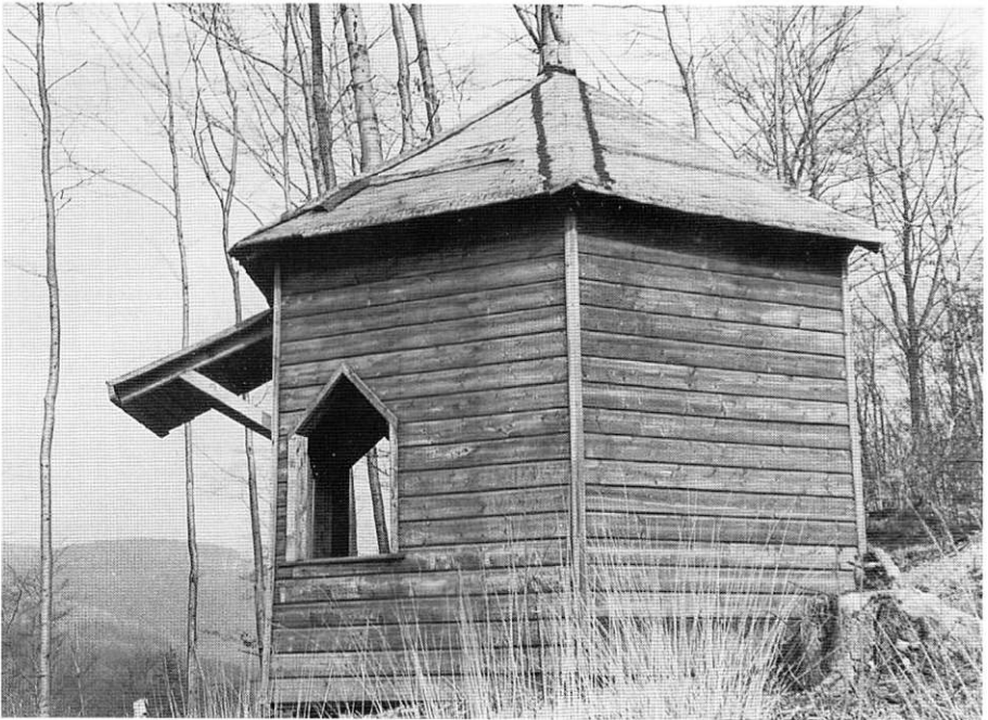
Unser Foto zeigt die baufällig gewordene „Göttinger Hütte“. Sie wurde abgerissen und 1978 durch eine neue Hütte ersetzt.
